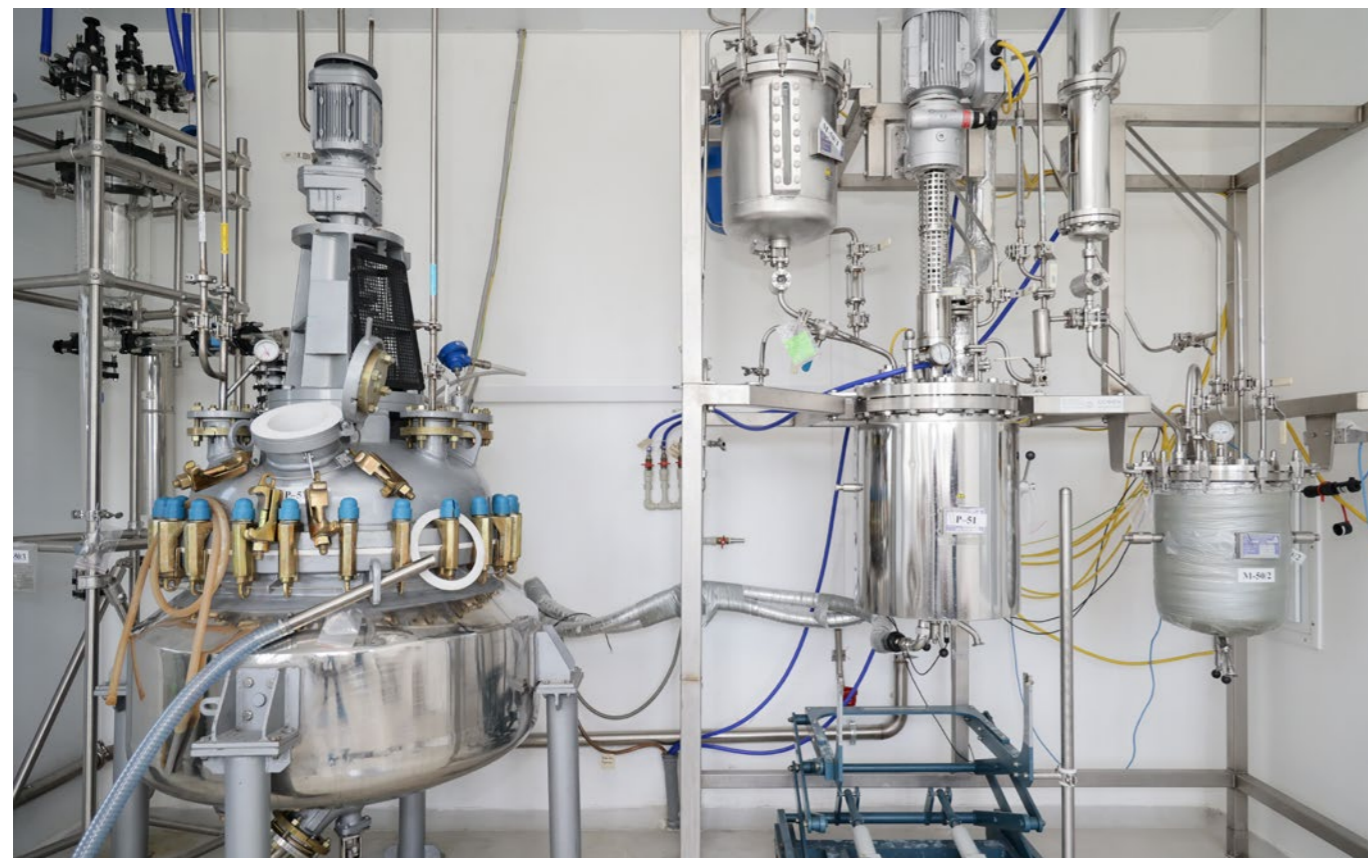
Реакторная зона опытно-производственного участка
